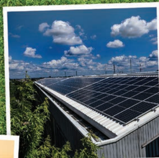
Installation Photovoltaïque Site ÉS de Mundolsheim
